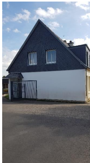
Bardage en ardoises naturelles à déposer
